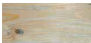
Herkömmliche farblose Lasur ohne UV-Schutz Folge: Irreparable Vergrauung / Bläueschäden
