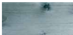
Unbehandelte Oberfläche Folge: Holz vergraut vollflächig
